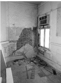
Key: 6-1-2.5ii Moisture damage.tif
