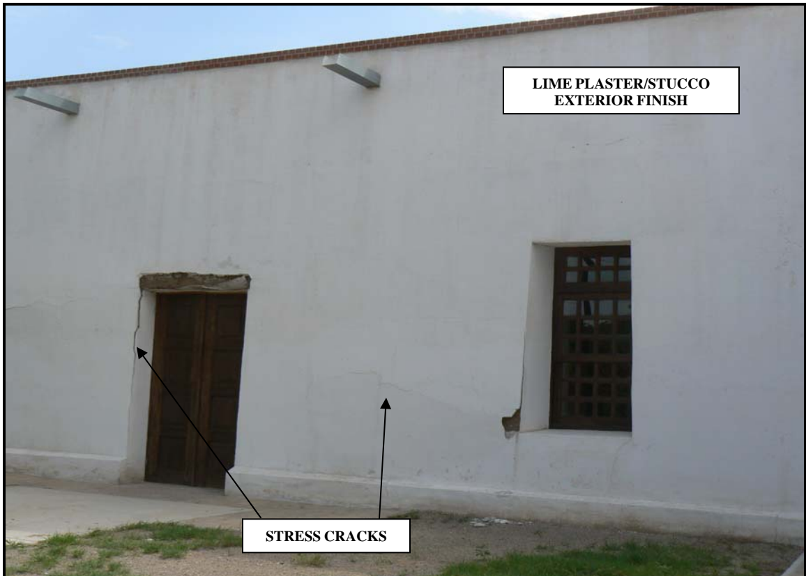
Nuestra Señora de la Limpia Concepcion de los Piros de Socorro del Sur at Socorro. Stress cracks can occur in all types of plaster finishes. Source: Baker, 2008.
