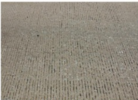
Narrow longitudinal crack
