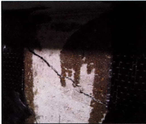
(d) Critical crack
